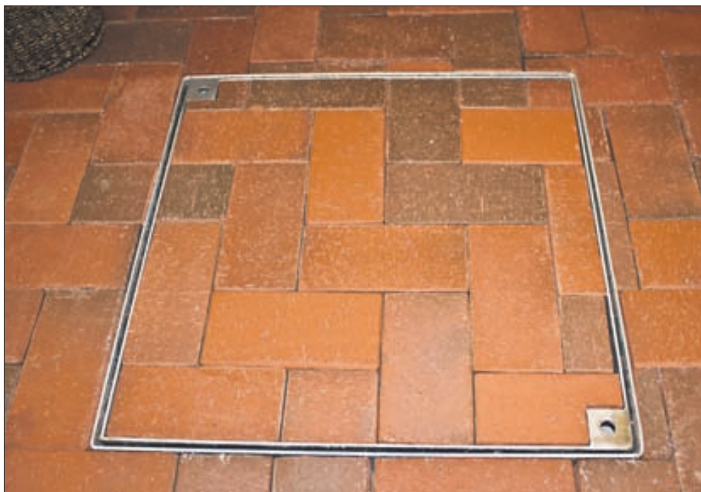
Hvor er kloakdækslet? Der er jo lige her - med belægningssten som overflade.
